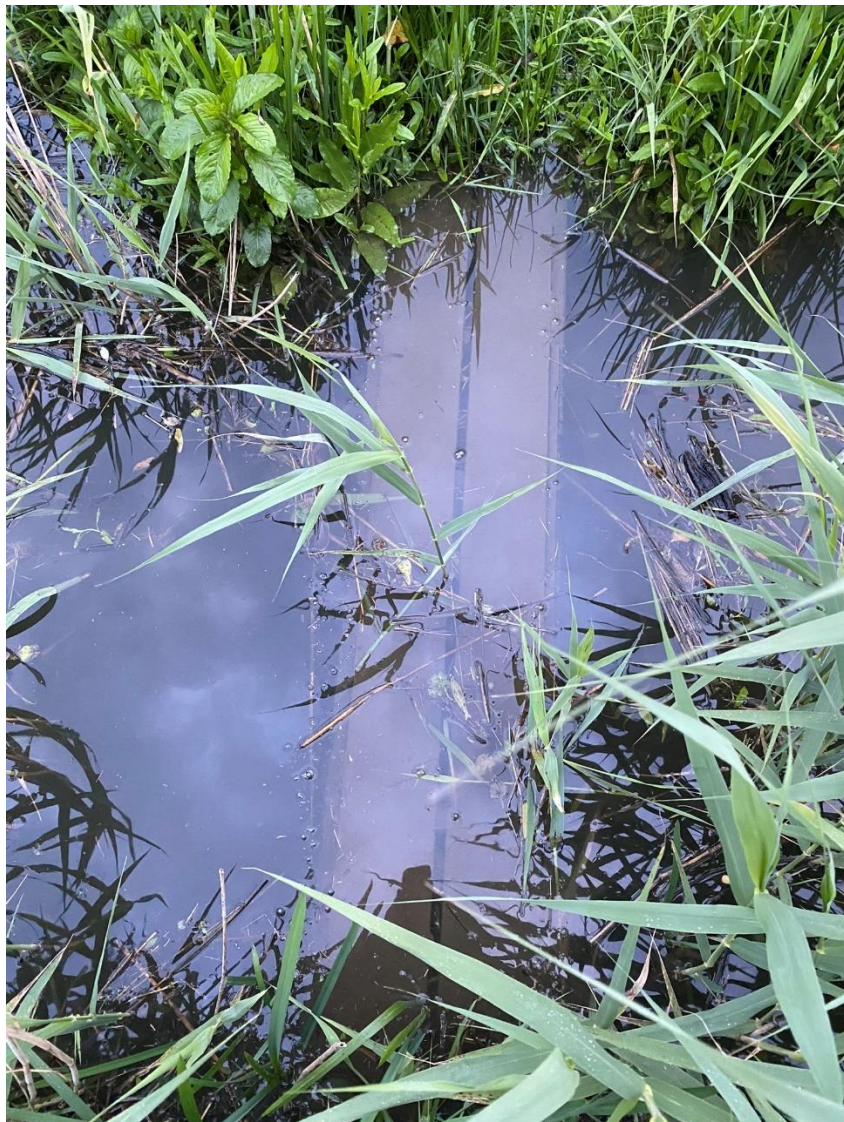
20 mei 2024 - ladderplank onder water in deel D
